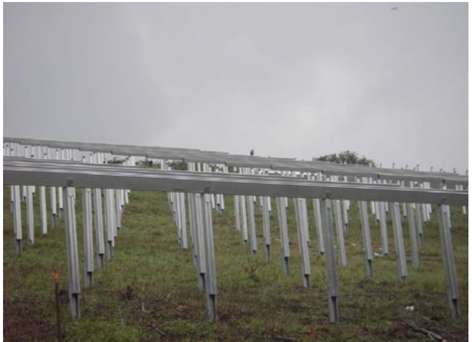
Unterkonstruktion mit nachjustierbaren Pfeilern zum Ausgleich etwaiger Setzungen des Deponiekörpers.
