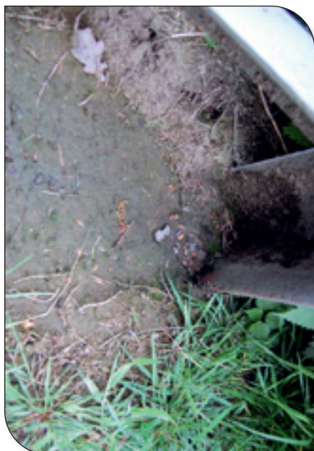
Hier kann man es gut sehen: Diese Anstrich blättert ab; so gelangen Schadstoffe in den Boden.
