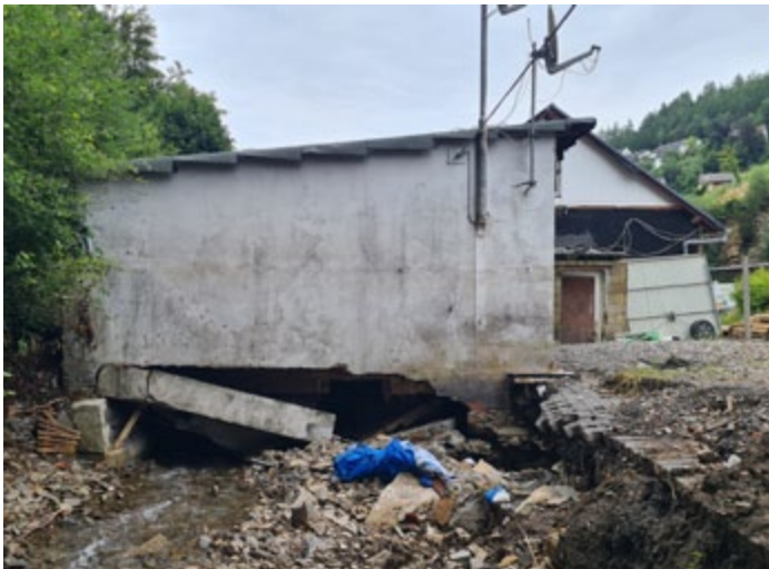
Das Wasser drückte von unten in ein Gebäude und riss den Boden weg.
