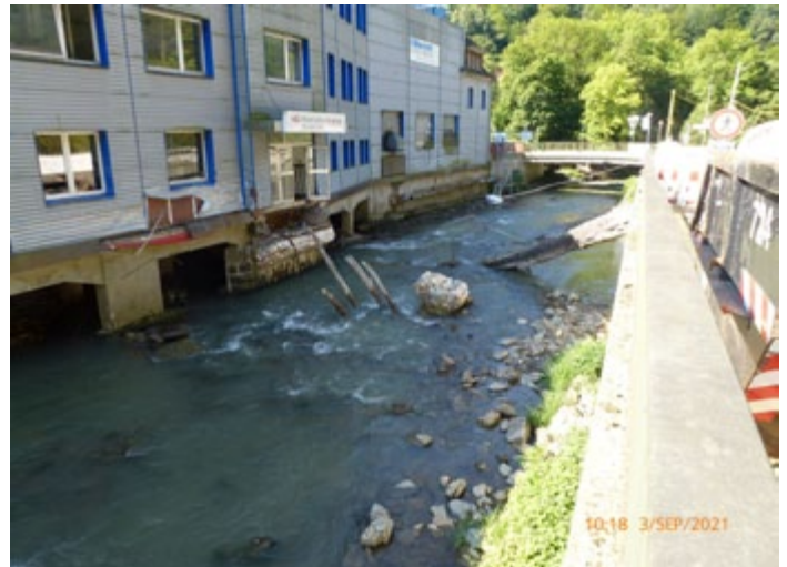
Eine Auswirkung der Starkregenereignisse vom 14. und 15. Juli im Märkischen Kreis war eine weggerissene Fußgängerbrücke zu einer Firma in Schalksmühle. Die Zerstörung verdeutlicht die Kraft des Wassers und die Notwendigkeit von Maßnahmen zum Hochwasserschutz.
