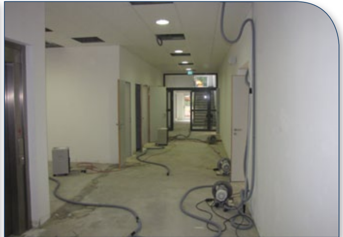
Sanierung eines Klassentraktes nach einem Leitungswassergroßschaden. Durch die gelöste Pressverbindung einer Kaltwasserkupferleitung floss über das Wochenende Trinkwasser ungehindert aus und beschädigte drei Etagen des Gebäudes. Einige Einrichtungen wie Oberböden wurden direkt entsorgt. Auf dem Bild erfolgt die Trocknung der Decken, Wände und Böden.
