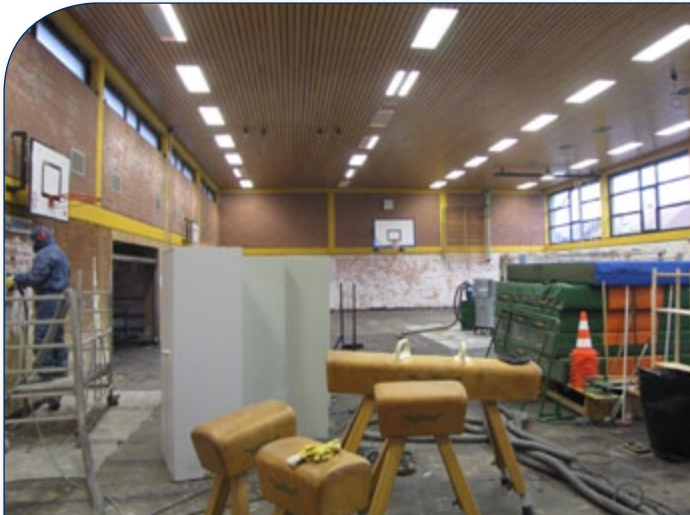
Sanierung einer Turnhalle nach einem Leitungswassergroßschaden. Hier erfolgte über einen längeren Zeitraum das unbemerkte Nachfließen von Kaltwasser aus einer Schadenstelle in den Hallenboden. Durch die langfristige Wasserausbreitung müssen Boden und Wände saniert werden.
