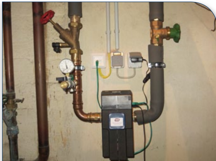
Installation einer automatischen Absperrereinrichtung mit integrierter Durchflussmessung.
